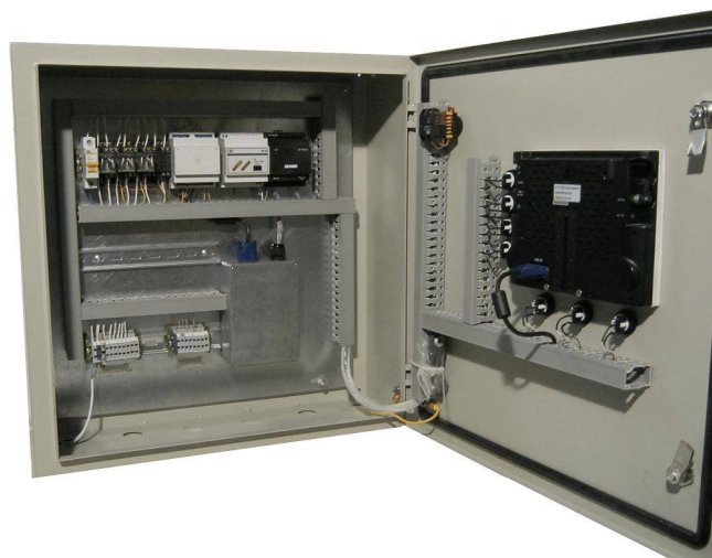
Внутреннее устройство шкафа управления
