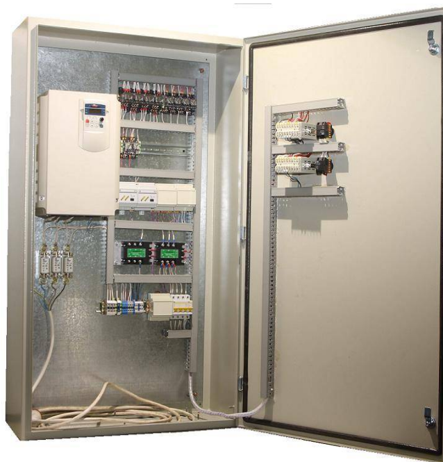
Шкаф с силовой аппаратурой
